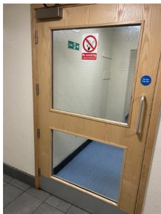
FD30 fire door
