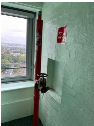
Dry riser outlet
