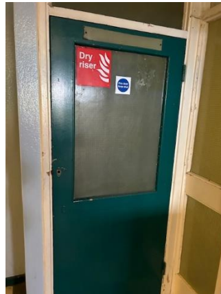
Dry riser outlet
