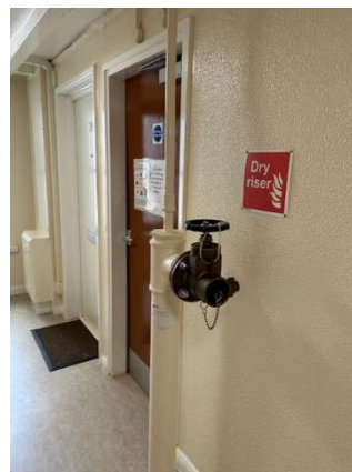
Dry riser outlet
