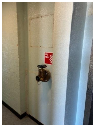
Dry riser outlet
