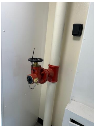
Dry riser outlet
