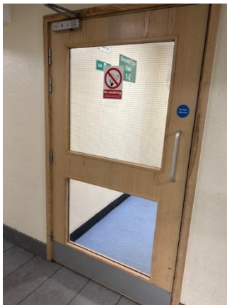
FD30 fire door
