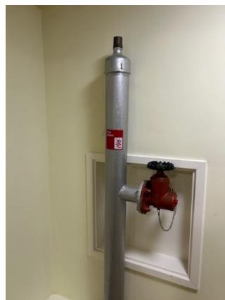
Dry riser outlet
