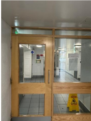
Nominal FD30 fire door
