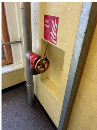
Dry riser outlet
