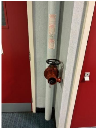
Dry riser outlet
