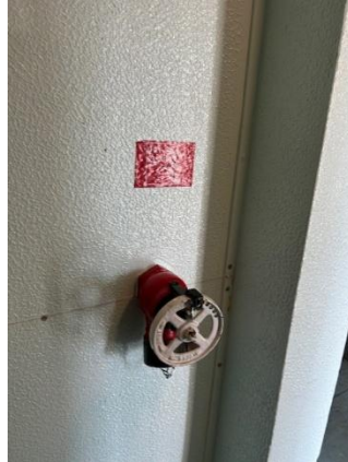
Dry riser outlet
