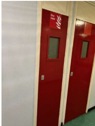
Dry riser outlet
